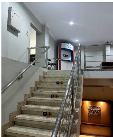
Gambar 2. Tangga Akses Tidak Dapat Diakses Difabel
